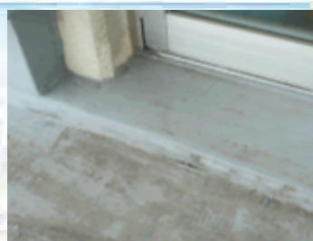
塗膜防水層の口開き
