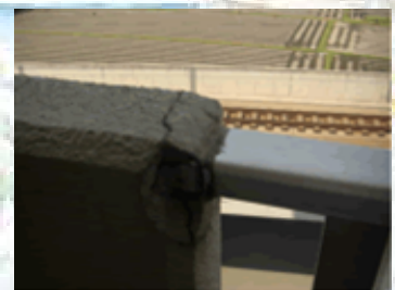
付根の爆裂欠損
